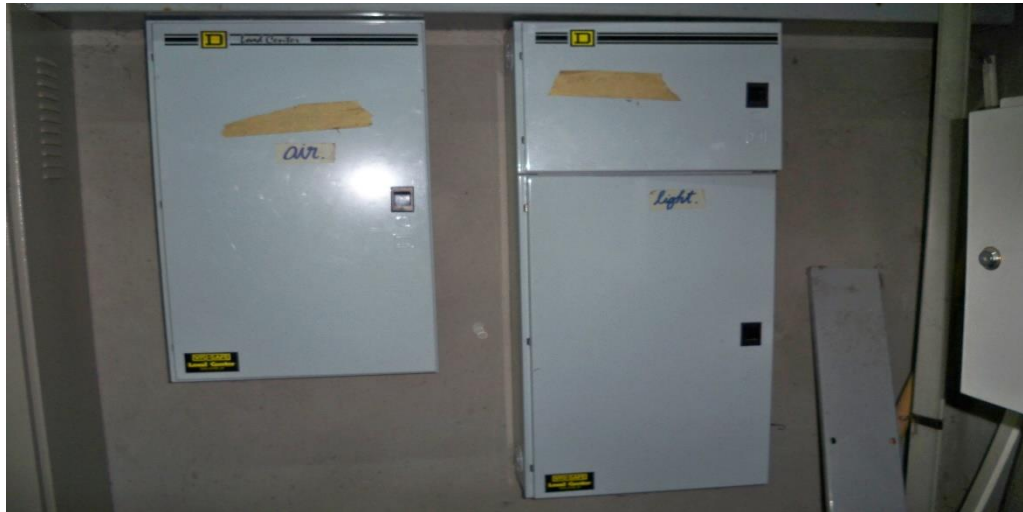
ตู้เมนส์ควบคุมไฟฟ้าชั้น 3
