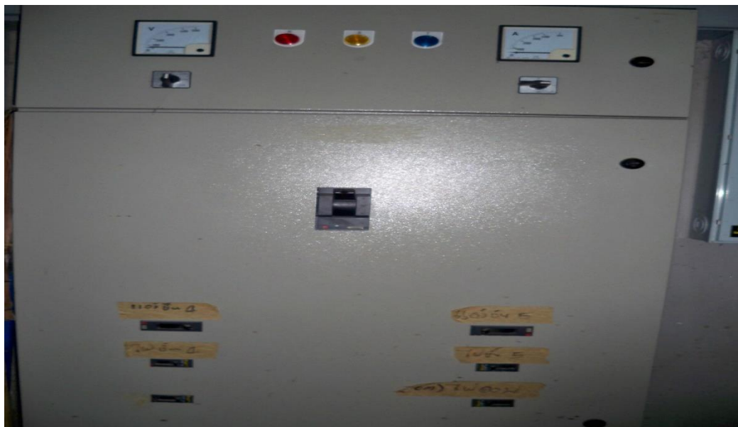
ตู้เมนส์ควบคุมไฟฟ้าชั้น 4
